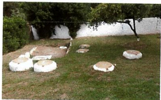
SISTEMA DE CAPTAÇÃO DE DEJETOS
